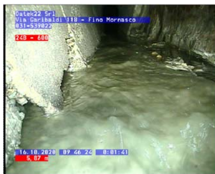
Rottura del tubo con parti mancanti
