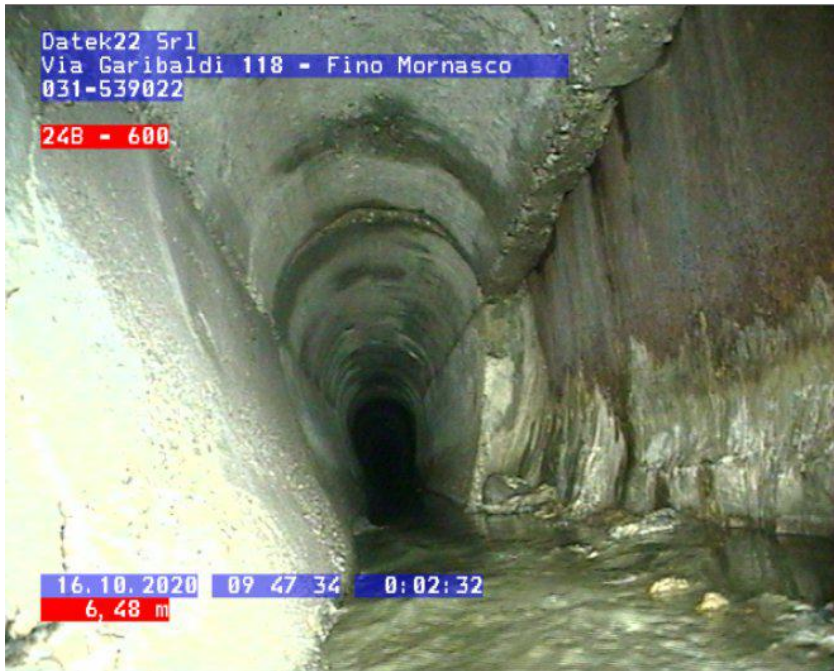
TUBAZIONE LINEA 24B - 600 Rottura/crollo, mancanza
