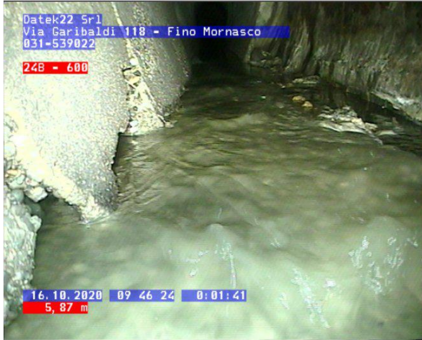
TUBAZIONE LINEA 24B - 600 Parti mancanti
