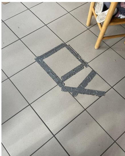
Fig. 3: piastrelle del pavimento non integre – sezione C.
