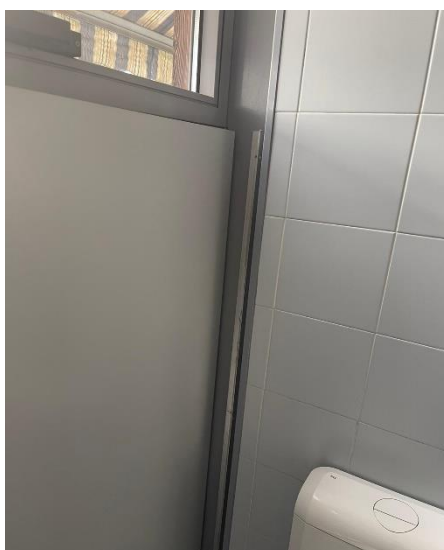
Fig. 1: pannello oscurante non adeguatamente fissato alla finestra – sezione C.
