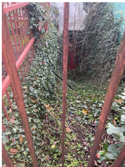
Fig. 8: recinzione esterna in ferro arrugginita.
