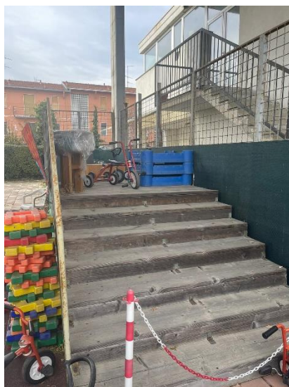
Fig. 6: scala con corrimano in ferro arrugginito.
