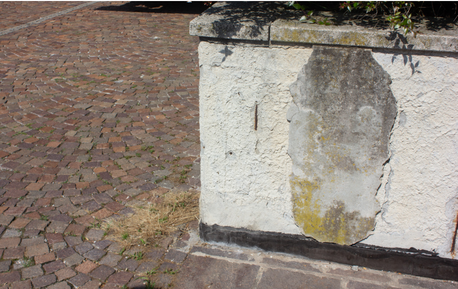
4 - Degrado muri di contenimento e fioriere
