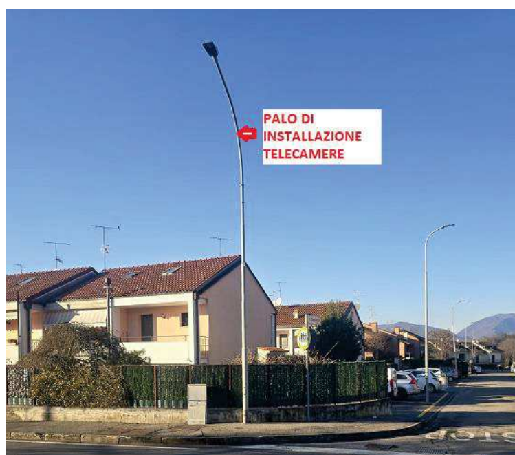
Foto 2 – Palo di installazione delle telecamere
