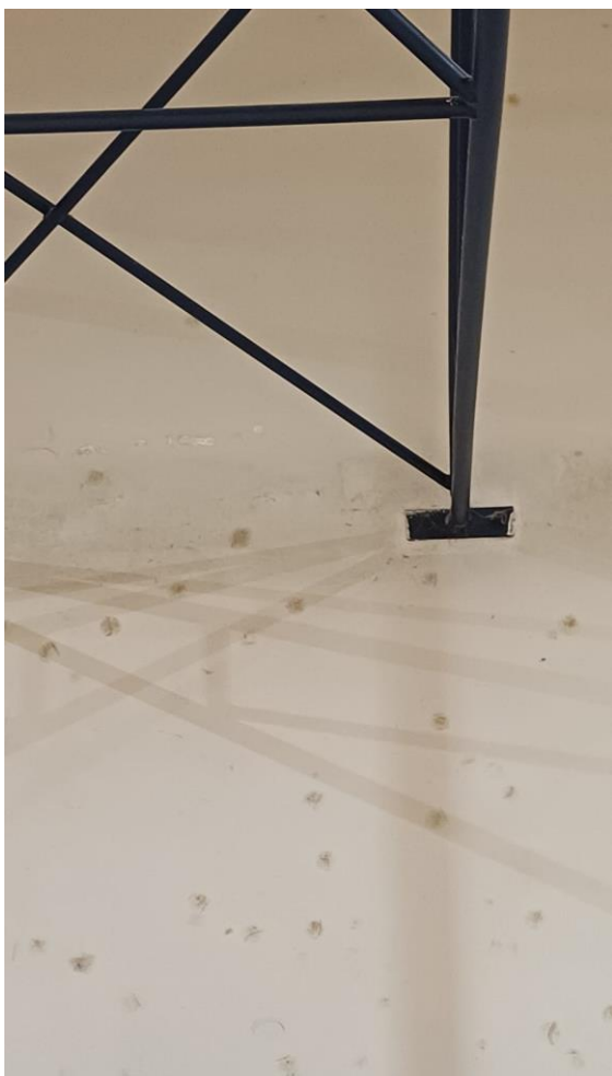
MACCHIE DI MUFFA SU TUTTI I MURI
