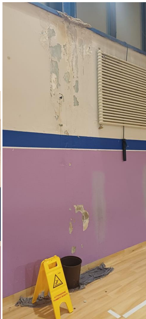
PERDITE D'ACQUA SULLA PARETE
