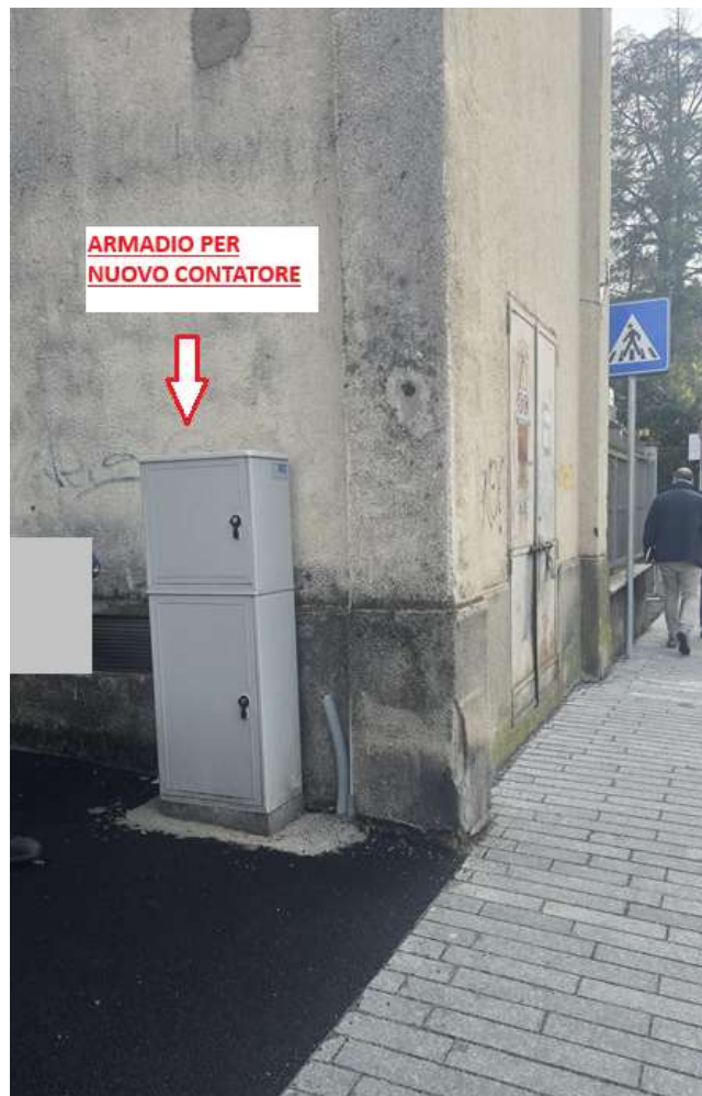
Foto 8 – Punto di prelievo alimentazione
