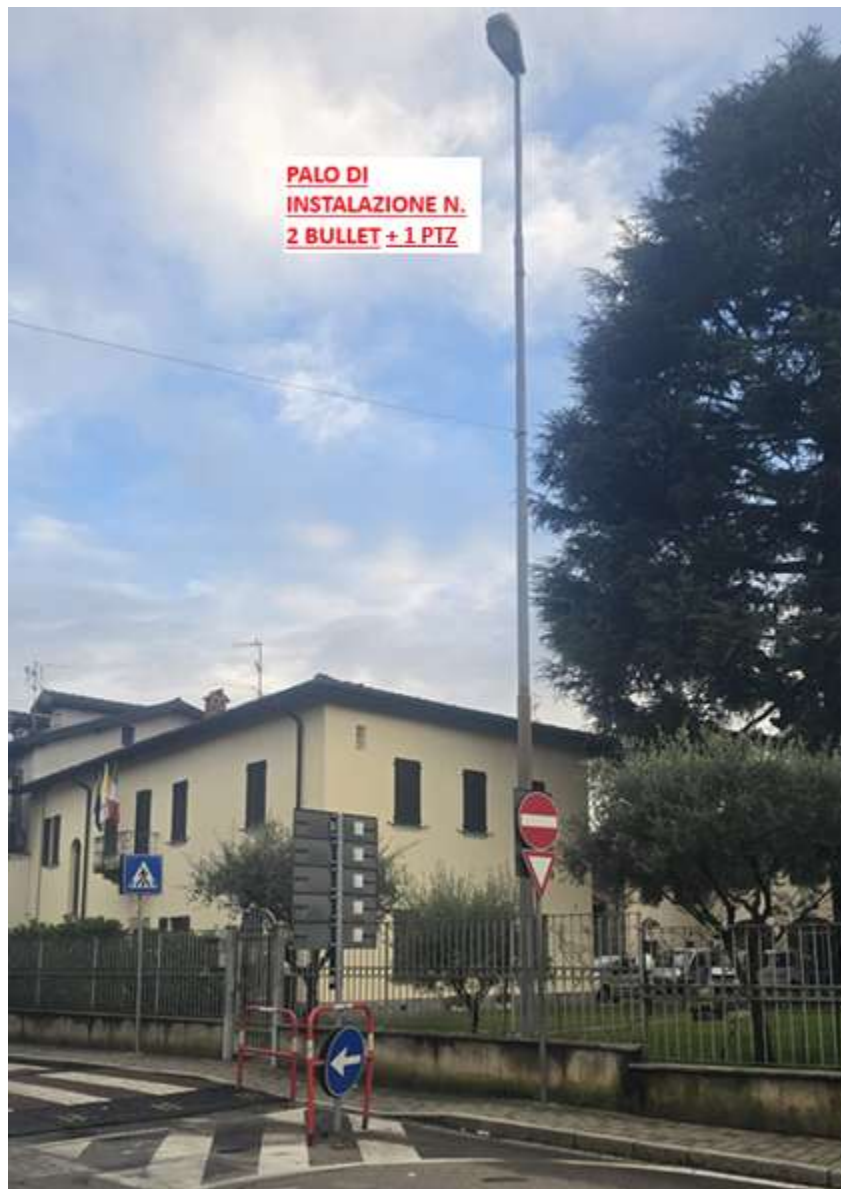
Foto 13 – Palo di installazione delle telecamere
