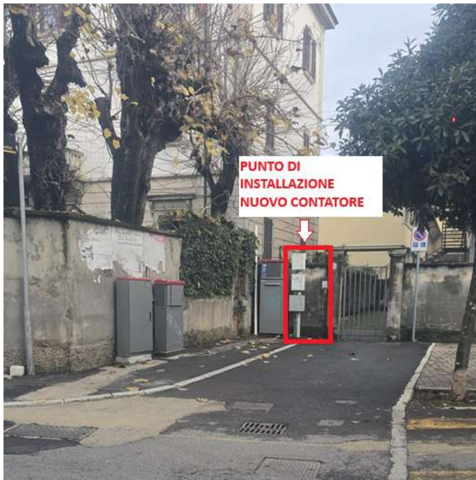
Foto 4 – Punto di prelievo alimentazione
