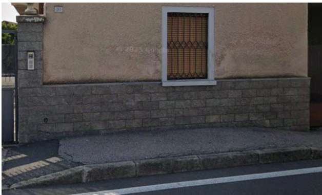
Figura 18 – Civico 30 - Esempio facciata da ripristinare
