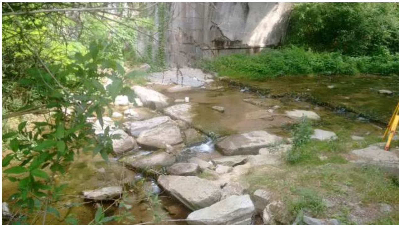
Figura 6. Platea in massi a valle del ponte
