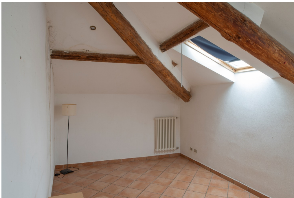
Tracce di infiltrazioni provenienti dal manto di copertura
