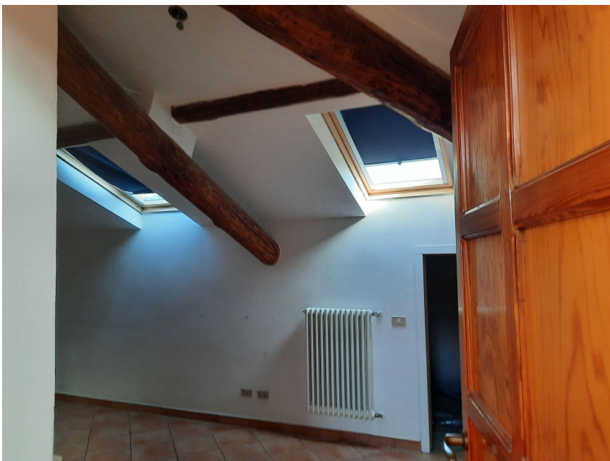
Immagine #22 - Comune di Malnate - Villa Ponzoni - Il sistema di emissione al piano sottotetto.
