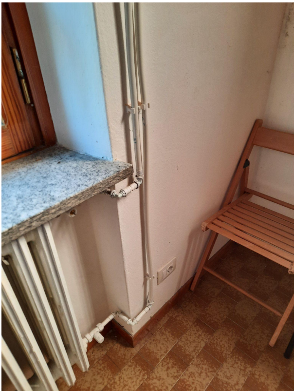
Immagine #20 - Comune di Malnate - Villa Ponzoni - Il sistema di emissione al piano secondo con il sistema di distribuzione dal soffitto.
