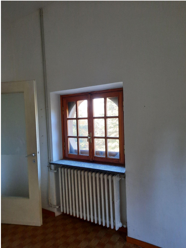
Immagine #19 - Comune di Malnate - Villa Ponzoni - Il sistema di emissione al piano secondo con il sistema di distribuzione dal soffitto.
