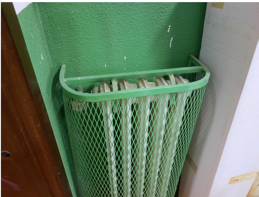
Immagine #14 - Comune di Malnate - Villa Ponzoni - Il sistema di emissione al piano terra con la grata di protezione.
