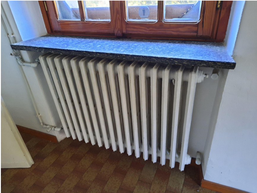
Immagine #17 - Comune di Malnate - Villa Ponzoni - Il sistema di emissione al piano secondo con il sistema di distribuzione dal soffitto.
