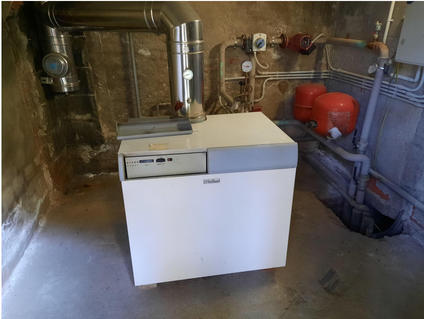
Immagine #25 - Comune di Malnate - Villa Ponzoni - Il generatore esistente presente nel volume tecnico all'esterno dell'edificio.
