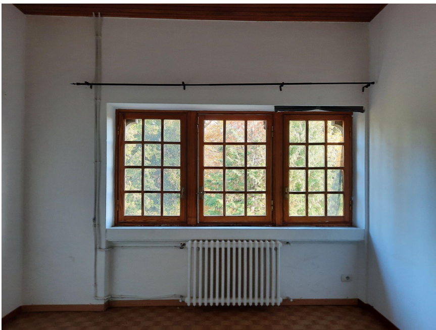
Immagine #18 - Comune di Malnate - Villa Ponzoni - Il sistema di emissione al piano secondo con il sistema di distribuzione dal soffitto.
