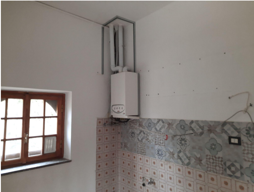
Immagine #21 - Comune di Malnate - Villa Ponzoni - Il generatore esistente presente nel locale cucina al piano secondo a servizio del piano.
