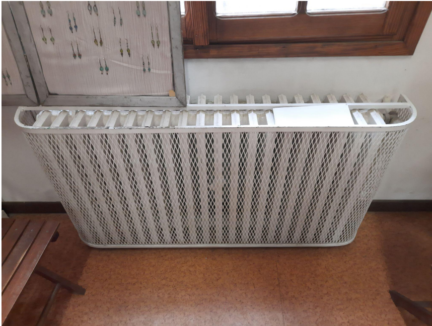
Immagine #13 - Comune di Malnate - Villa Ponzoni - Il sistema di emissione al piano terra con la grata di protezione.
