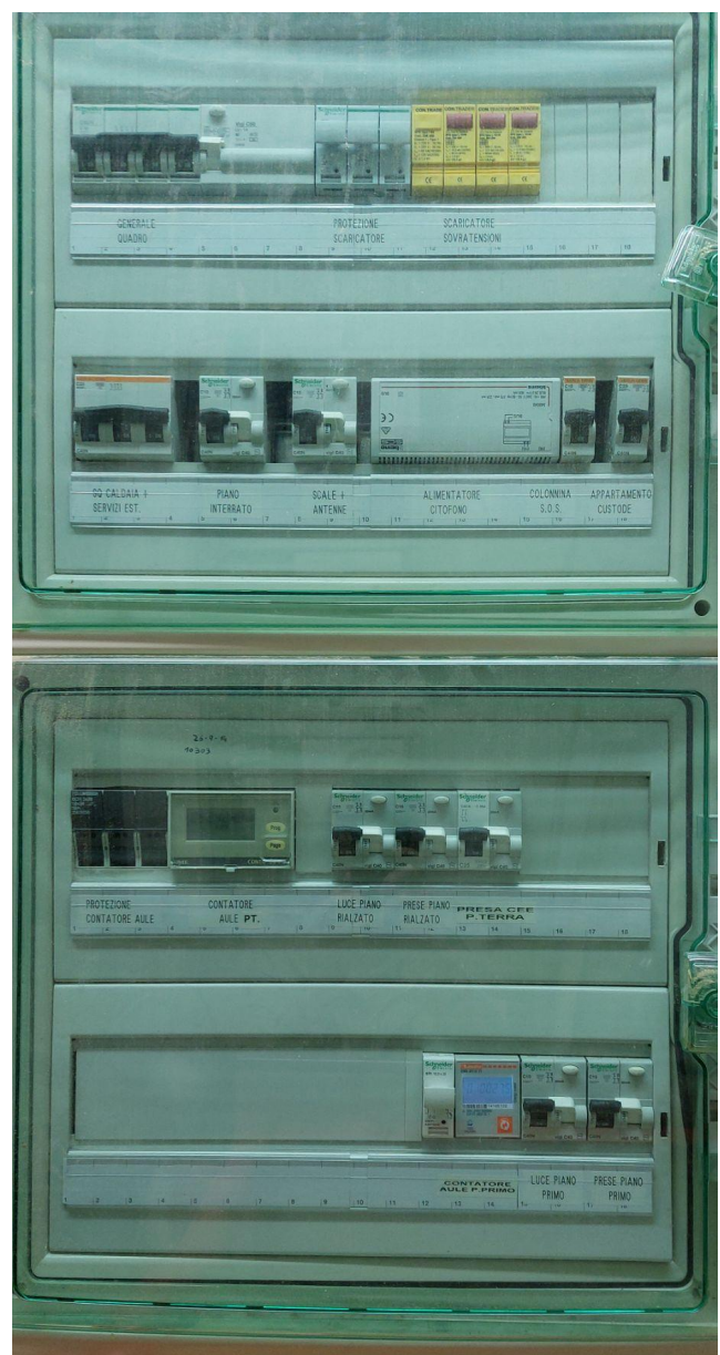
Immagine #12 - Comune di Malnate - Villa Ponzoni - Il quadro elettrico al piano interrato.
