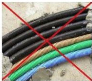
Figura 5a - Posa errata
