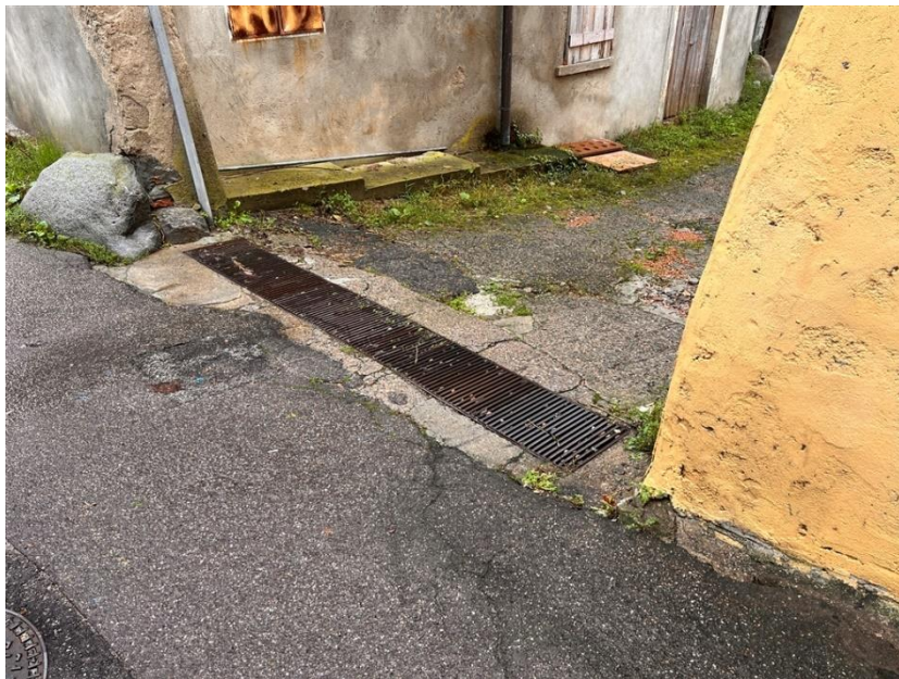
Griglia di drenaggio a protezione della zona più bassa della frazione
