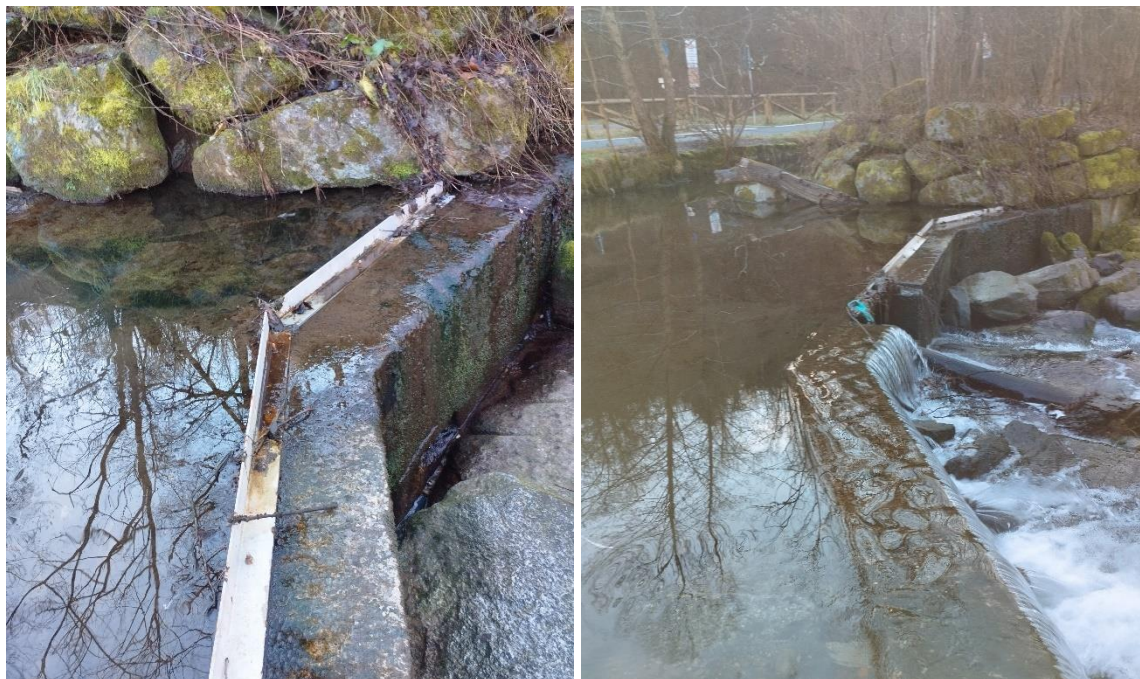
Manufatto iniziale di separazione tra Torrente Lanza e Roggia Molinara
