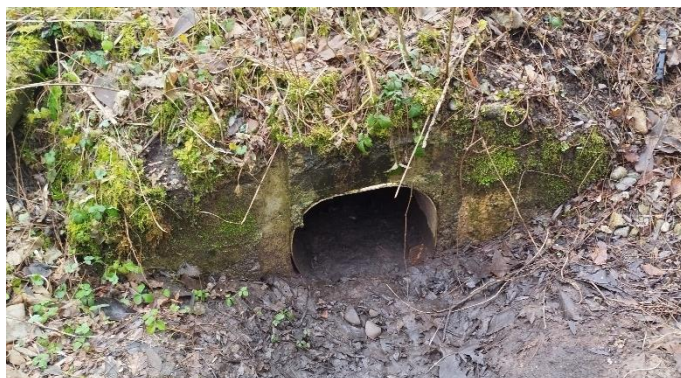
Scarico in prossimità dell'incrocio tra Ferrovia Valmorea e Ponte della via Varese. Probabile scarico delle utenze a ridosso della Strada Statale di Via Zara
