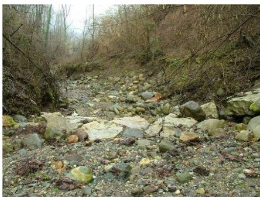
Manufatti di sbocco del tratto tombinato in corrispondenza dei due rami, principale e secondario e tipologia di alveo a valle
